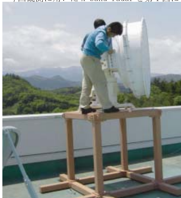
第 1 図福島大学屋上に設置した X-band Radar
